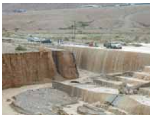
איור 5.5: סחיפת כביש בנחל דרוגות (המקור: אבני וחוברין, המכון הגיאולוגי, GSI/18/2004)
