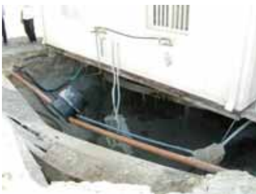
איור 2.3: סולריום עין-גדי, בולענים שנפערו בכביש הגישה לאתר (למעלה) ומתחת למבנה (למטה) (המקור: רז, 2004)
